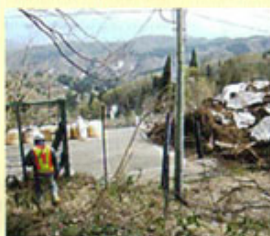
4.30 流出した土砂により塞がれた道路
